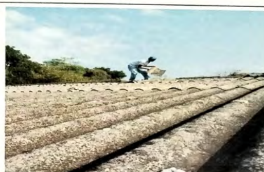
Foto 2: MODULO AULAS vista de cubierta de asbesto en malas condiciones.
