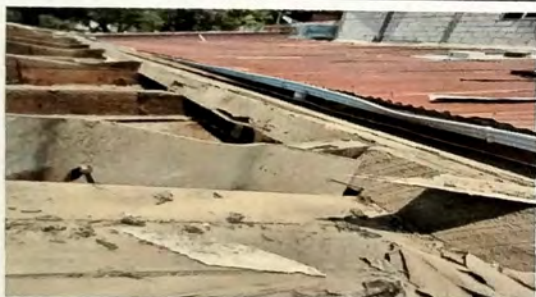
Foto 3: Vista de artezonado de madera en malas condiciones de desmontara del modulo.
